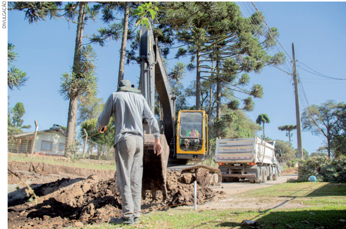
As ruas receberão serviços de drenagem, escavação, terraplanagem e preparação da base
