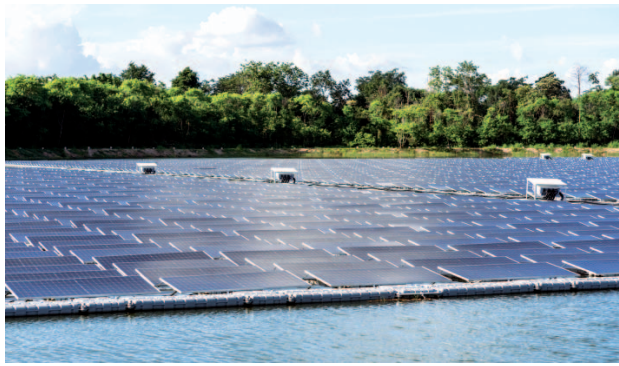
Imagem ilustrativa de usina solar flutuante
