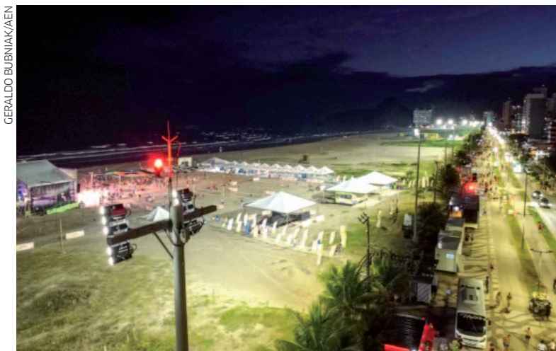
Superpostes fazem a iluminação pública da nova orla de Matinhos
